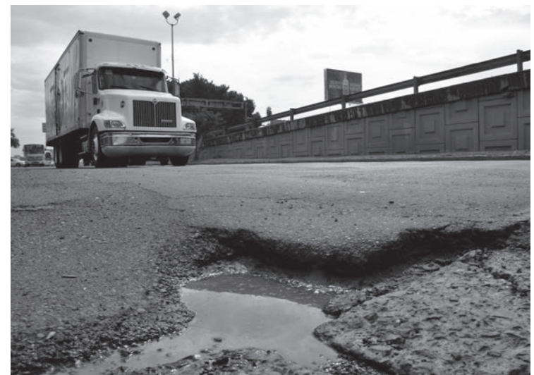
Piden reparar carpeta asfáltica en Lázaro Cárdenas
